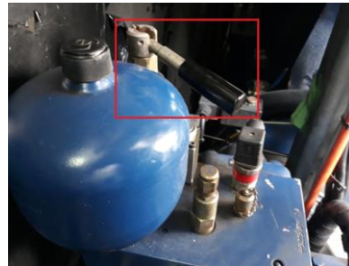
Palanca en posición cerrado del circuito hidráulico / Hydraulic system with handle in close position
