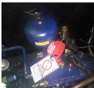
Palanca bloqueada / Pole lock out tag out
